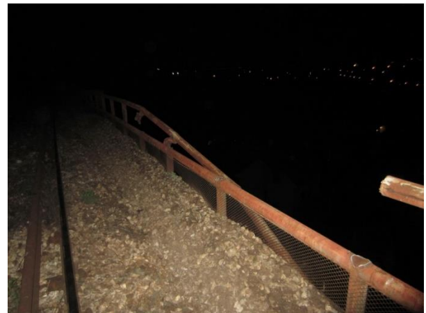
Слика 4.1.10: Оштећење ограде моста
