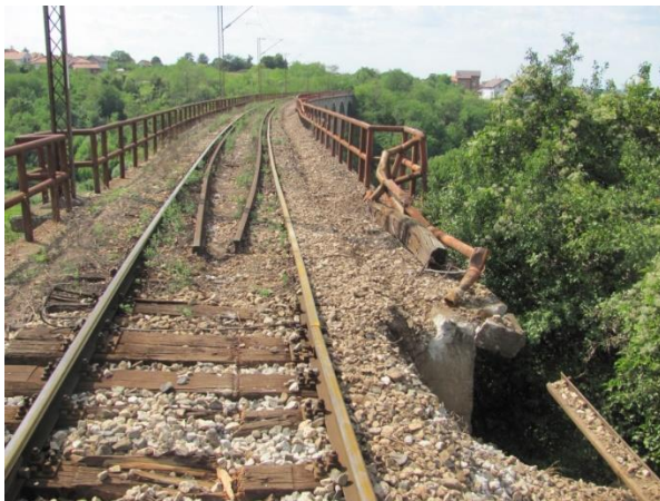
Слика 4.1.9: Место удара кола у почетак бетонске конструкције моста
